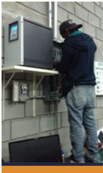
Mantenimientos eléctricos FIRST CASH
